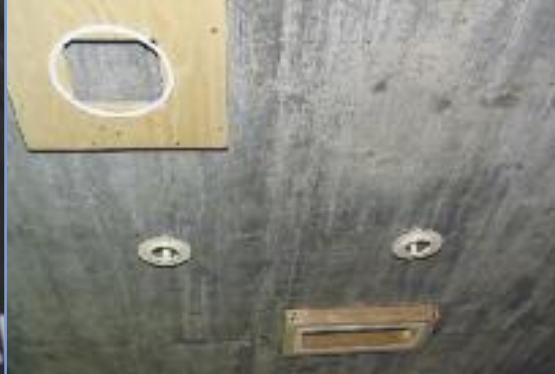
Unterkonstruktionen für Einbauleuchten werden angebracht Sub-construction for the built-in lighting are fitted
